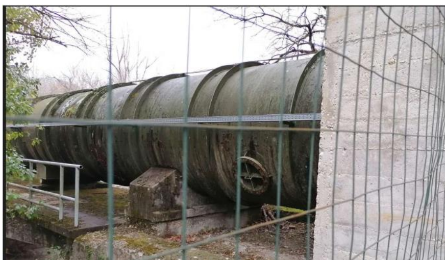
Figura 166: presa diretta dalla condotta di adduzione
