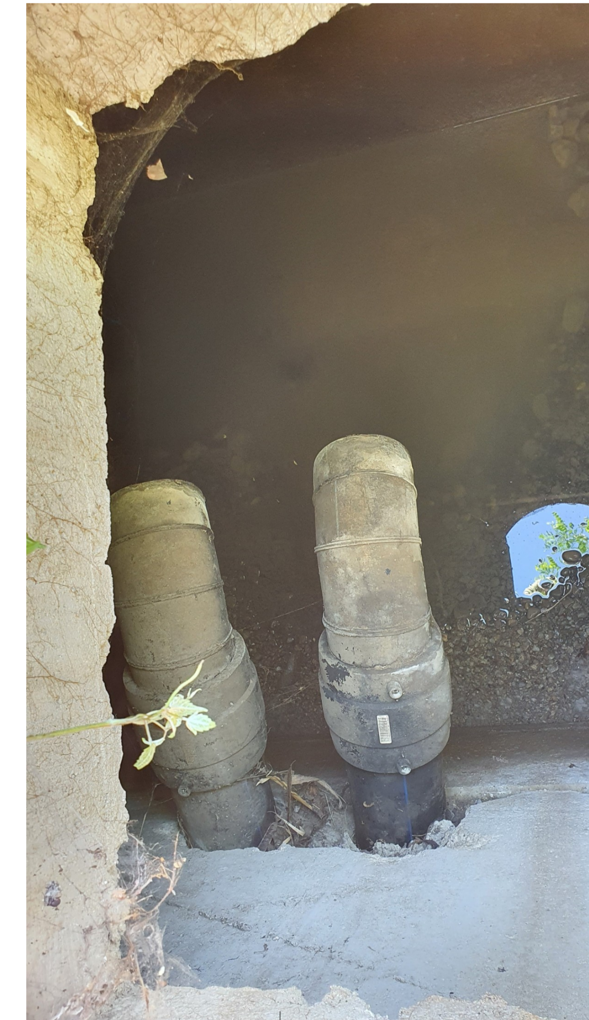
Foto 3- Condotte in ingresso al pozzetto di sollevamento
